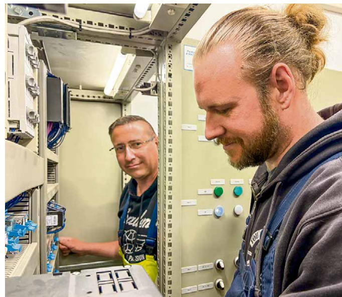
Elektrotechnik ist Teamarbeit. Hier schauen Martin Bauernschäfer (l.) und Roy Erler, ob im Schaltschrank vom Wasserwerk Zinnowitz alles in Ordnung ist.
