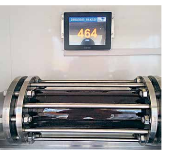
Im Glaszylinder zeigt sich, wie trüb das Wasser ist. Im Laufe der Spülung wird es immer klarer. Gespült wird so lange, bis alle Grenzwerte erreicht sind. Foto: ZV
