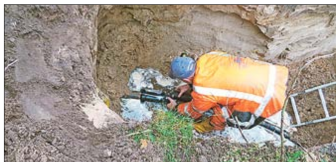
Havarie: In der Haffstraße in Dargen hat die Trinkwasserhauptleitung einen Riss. Thomas Kruse dichtet das Rohr wieder ab.
