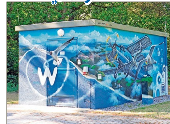
In den Verbandsfarben sowie mit ortstypischer Gestaltung präsentiert sich das Pumpwerk am Flughafen.
